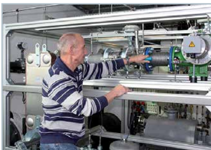
Andreas Obermeier von der Uni Bayreuth baut eine ORC-Anlage, die für Biogas-BHKWs eine neue Möglichkeit der Abwärmenutzung eröffnet.
