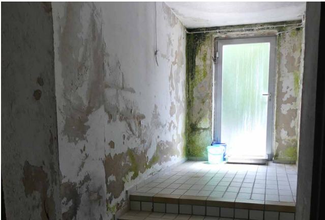
Abb. 38 Kellergeschoss - Baumangel Feuchtigkeit, Staunässe
