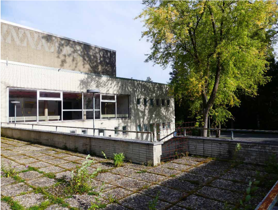
Abb. 64 Begehbare Flachdach mit sichtbaren Schäden
