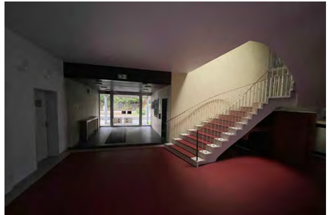
Abb. 29 Eingangssituation - nicht barrierefrei
