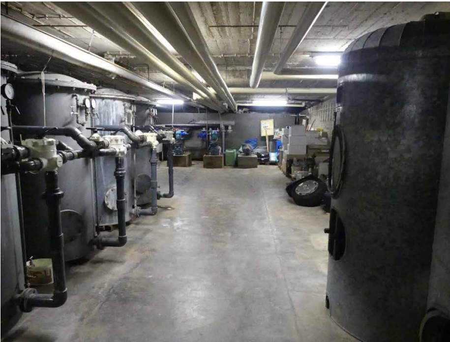
Abb. 69 Blick in den Schwimmbadtechnikraum
