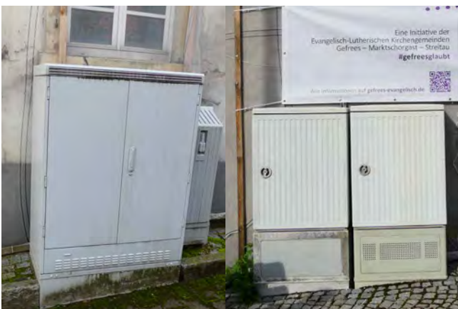
Abb. 38 Stromkästen an der Nord- und Südwand
