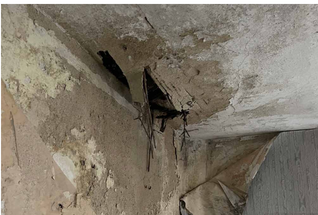
Abb. 50 Schäden an der Decke
