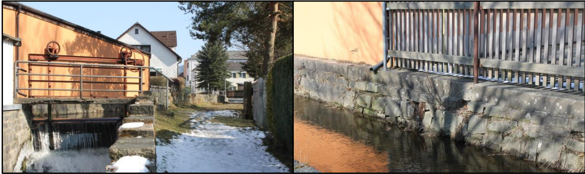
Abbildung 69: Kornbach am Wehr im westlichen Bereich (links), Schäden in Ufereinfassungen (rechts)
