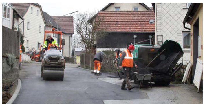
Gewissermaßen als Geschenk für die Metzlersreuther konnten die Arbeiten der Wasserleitungssanierung noch vor Weihnachten abgeschlossen werden, wie Bürgermeister Oliver Dietel freudig dem Bauausschuss vermeldete. Foto: Judas
