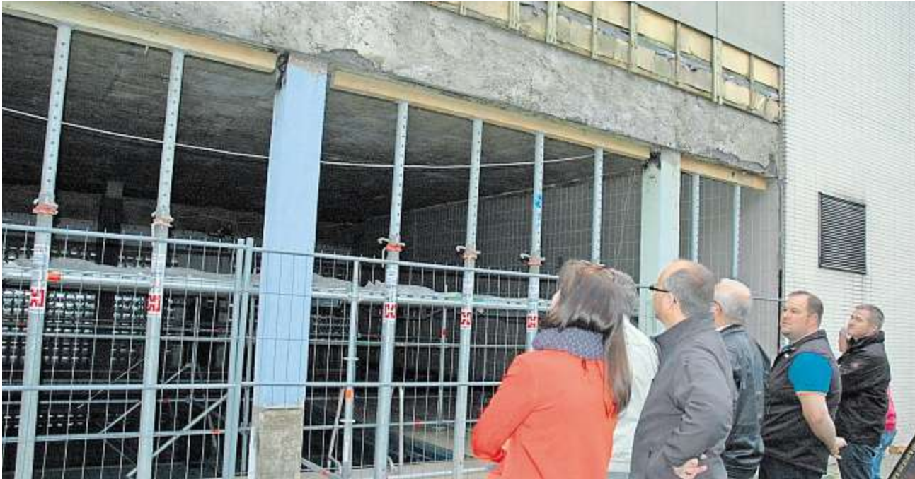
Der Bauausschuss verschaffte sich vor Ort einen Überblick über die Schäden an der Stadthalle.
